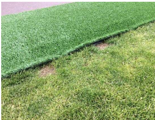
Slab stik med naravno in umetno trato v pasu okoli igrišča velika nevarnost za padec, ob katerem se bo igralec verjetno poškodoval.
