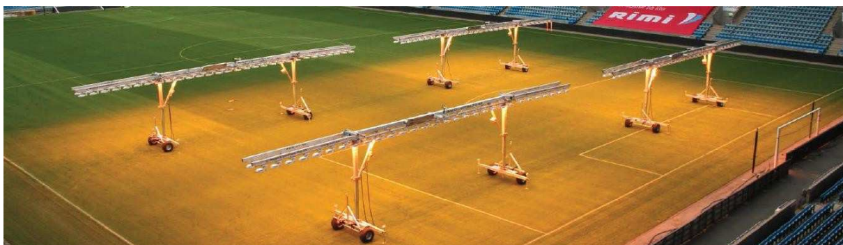
Slika 12 – Razsvetljavne naprave z zložljivimi rokami (zgoraj) in zapornimi rokami (spodaj).
